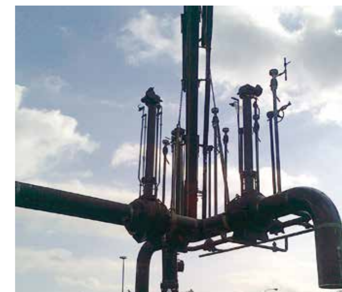
Línea de gas Gas pipeline
